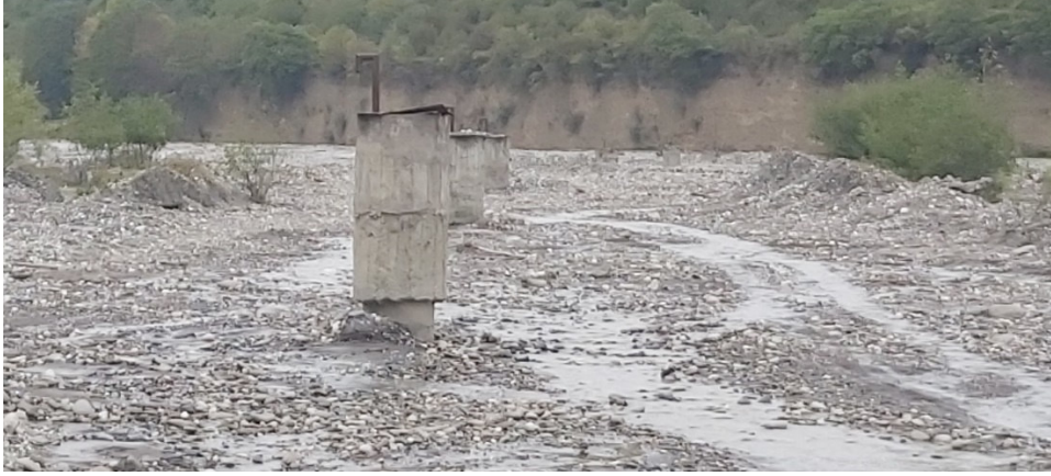
Şekil 5. Kudyalçay'daki drenaj borularının acil durumu
