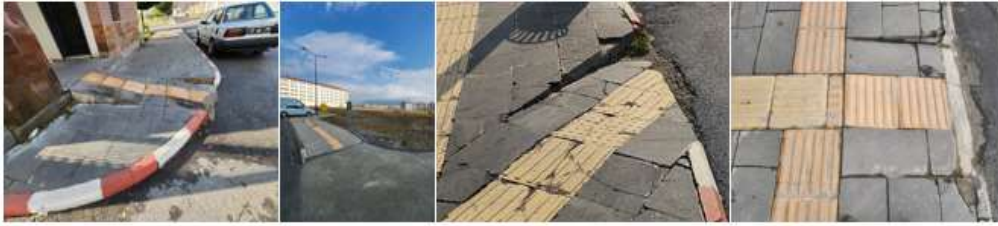
Şekil 17. Engelli dolaşımı için uygun olmayan rampalar
